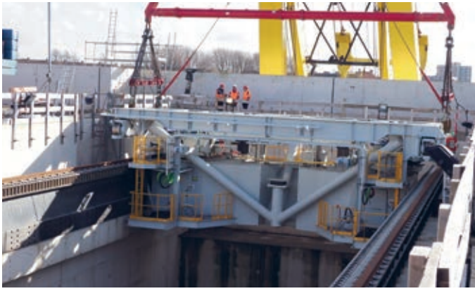
Während des Absenkens der pneumatische Senkkästen half ein Echtzeitüberwachungssystem dabei, die Verformungen der Torkammern innerhalb der Toleranzen zu halten. Foto: Ko van Leeuwen
